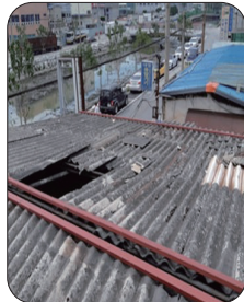
지붕재 노후화로 파손되어 떨어짐
