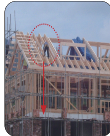
지붕 트러스, 철골 구조물 위 지붕 판넬 설치 중 떨어짐
